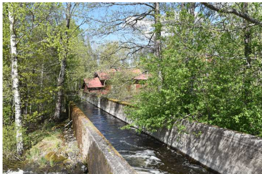
Kuva: Betonikouru padolta päin kuvattuna. Vuonna 2003 vesimyllyinventoinnissa todetaan, että kourusta puuttuu välppä juuri ennen turbiinia, joka on turvallisuusriski silloin kun vettä juoksetetaan kourua pitkin.
