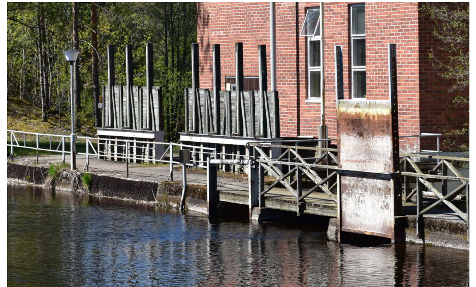
Kuva: Tasoluokkuja liikutellaan niitä varten tehdyissä metallirakenteisissa luukkuurissa pystysuunnassa.
