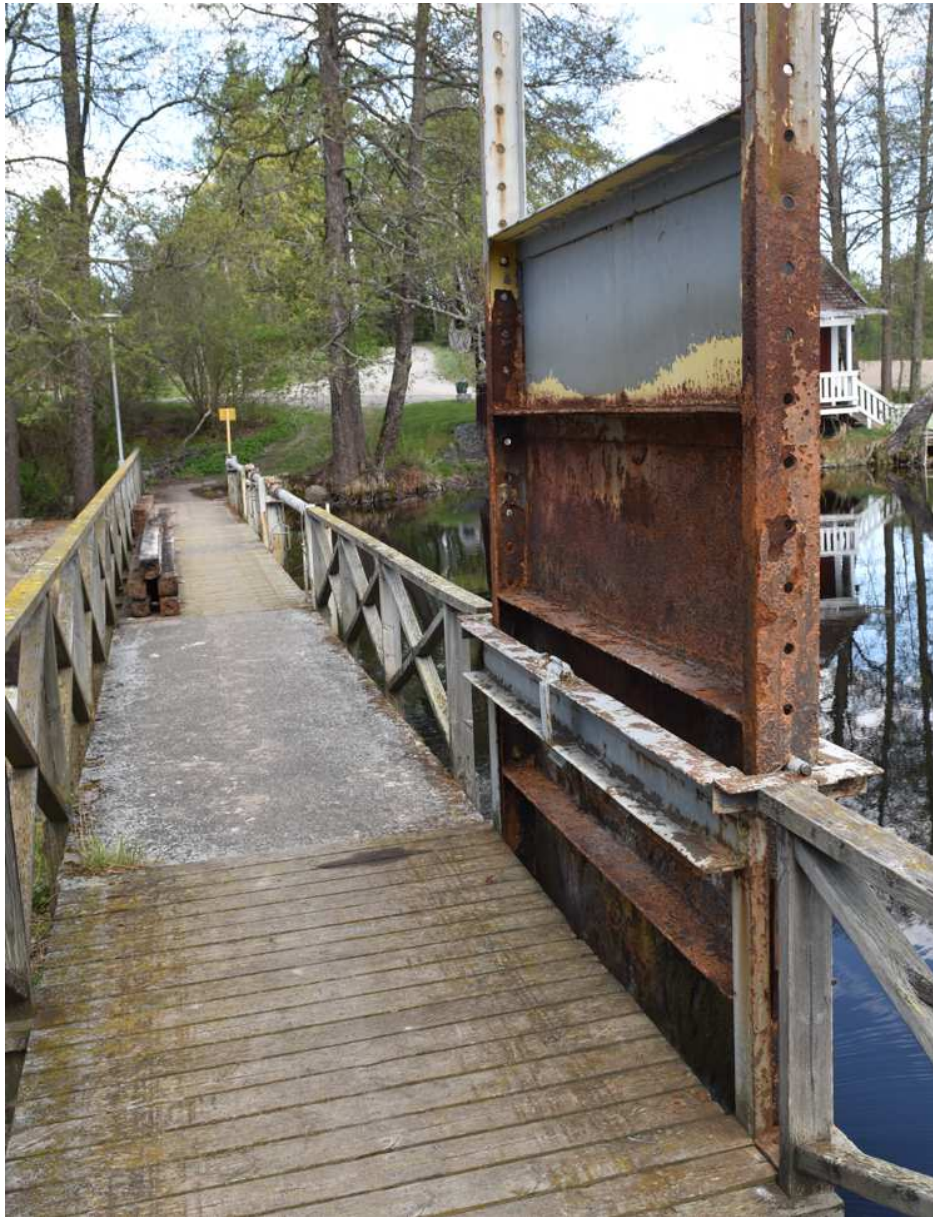
Kuva: Ruostunut teräslevyluukku.
