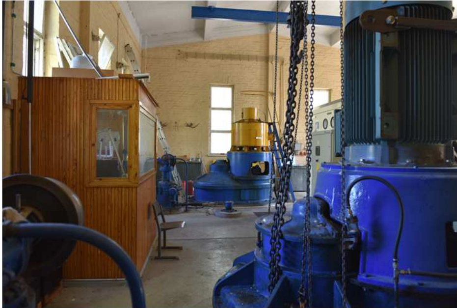
Kuva: Valvontakoppi ja pystygeneraattori.
