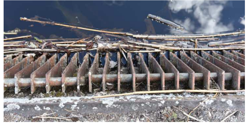
Kuva: Välppä. Välpillä tarkoitetaan montussa olevaa esterakennetta, jonka pystysuuntainen välppäritilä pysäyttää läpimitaltaan tietynkokoisen aineksen ennen turbiinia.
