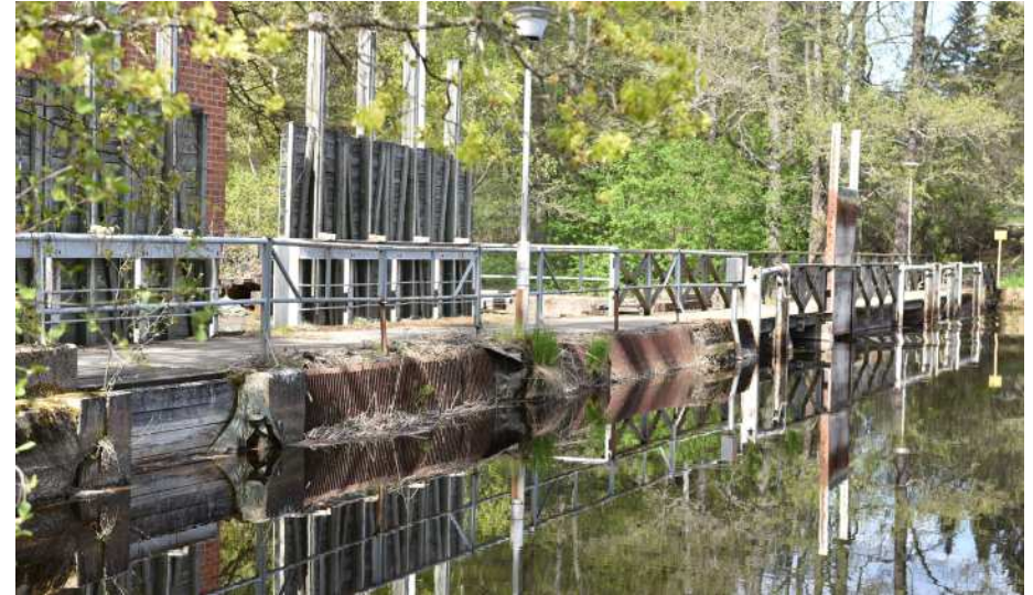
Kuva: Puurakenteisia teräsvahvisteisia luokkuja ja rautaväljät etualalla ja teräslevyluokku keskemällä uomaa, jossa on puurakenteisia settipatoja.
