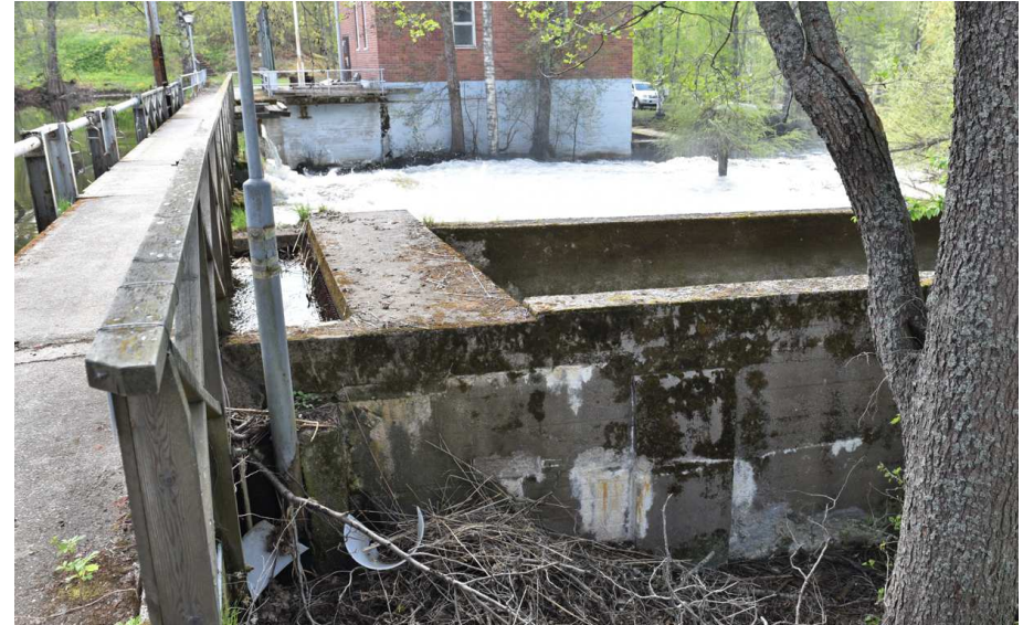
Kuva: Vanhaan voimalaitokseen johtava betonikouru ja välppä. Kouru tehty lautamuottivaluna. Seinämissä on säännöllisin välein vahvikkeita.
