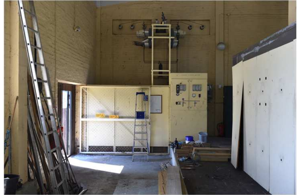
Kuva: Ulko-ovi ja muuntaja.
