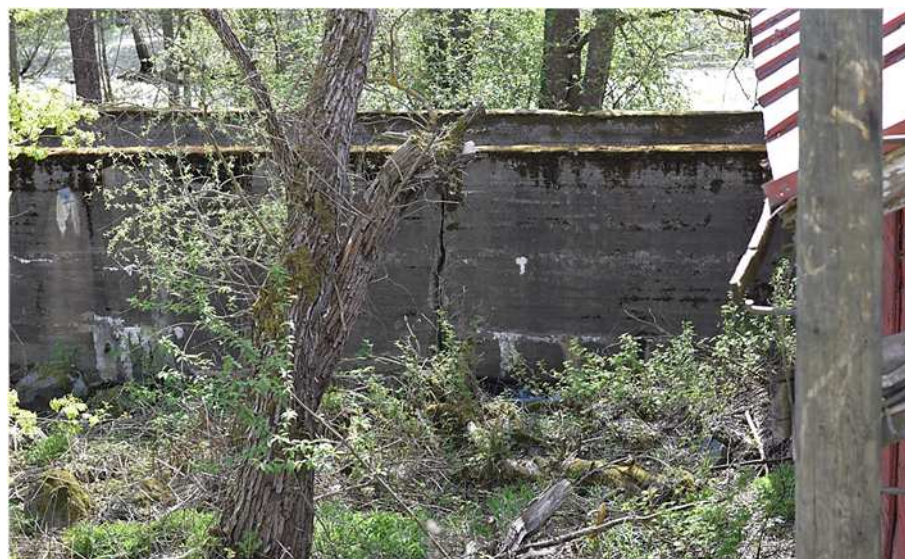
Kuva: Betonikourun seinämissä on halkeamia.
