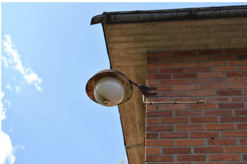
Kuva: Vanha ulkovalaisin. Betoniräystä.
