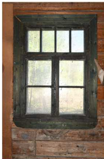
Kuva: Konehuoneen ikkunalistoissa on rihlattu pinta. Sisäpokia on erilaisia.
