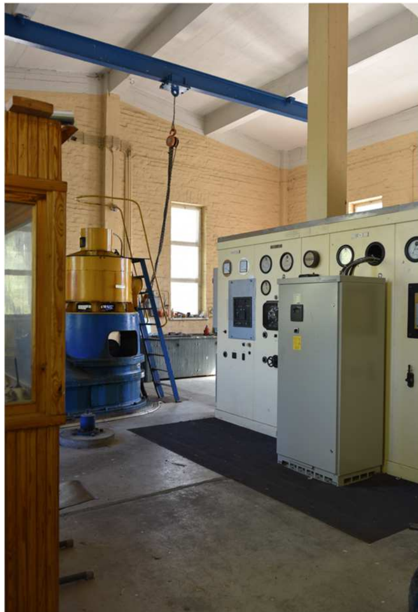
Kuva: Valvontakoppi, pystygeneraattori (Valmet) ja kojetaulu. Sisätilojen järjestys vastaa 1956 laadittua pohjapiirustusta. Slammatut ja maalatut tiiliseinät sekä paikalla valetut betonirakenteet ja -katto.
